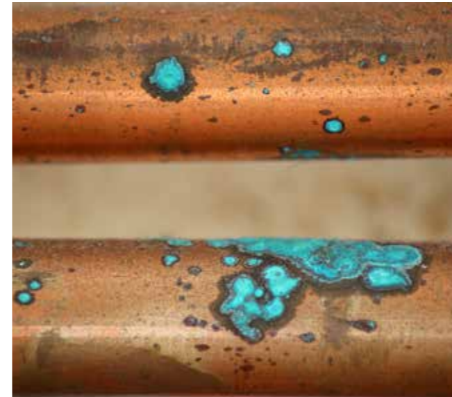
Buhar difüzyon direnci düşük malzeme ile yalıtılmış boru
